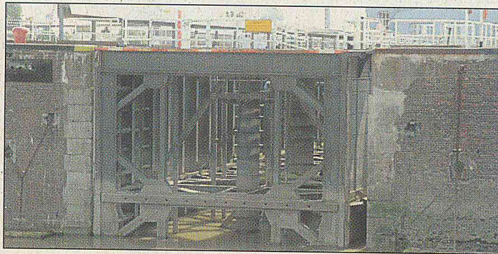
Baufällig: Die Großen Schleusen in Brunsbüttel.
